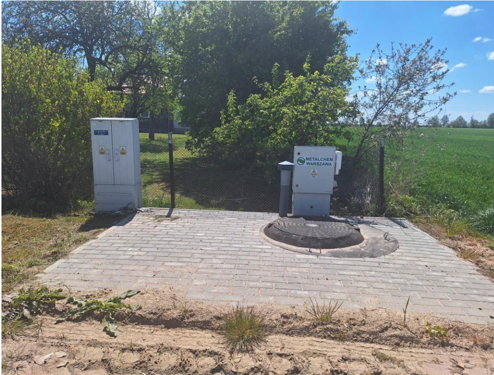
Przepompownia ścieków w miejscowości Hruszniew
