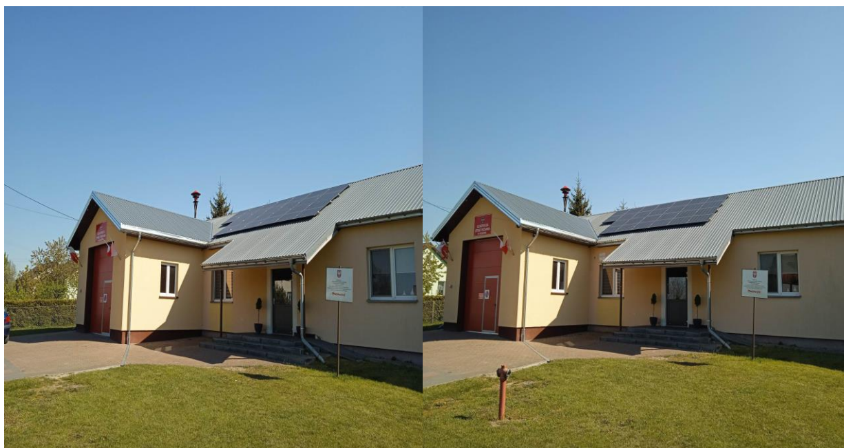
Instalacja fotowoltaiczna na budynku Ochotniczej Straży Pożarnej w Ruskowie
